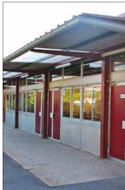
Le BP 2020 prévoit le changement des menuiseries (d'origine) de la façade de la salle polyvalente Pasteur.
